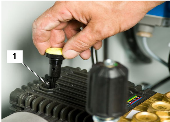
Öleinfüllöffnung mit Peilstab
